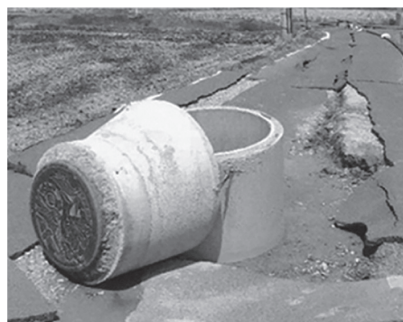
液状化による浮遊現象
